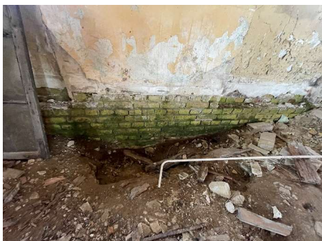
Eks. på opstigende grundfugt. Sådan ser bygningen ud hele vejen rundt
