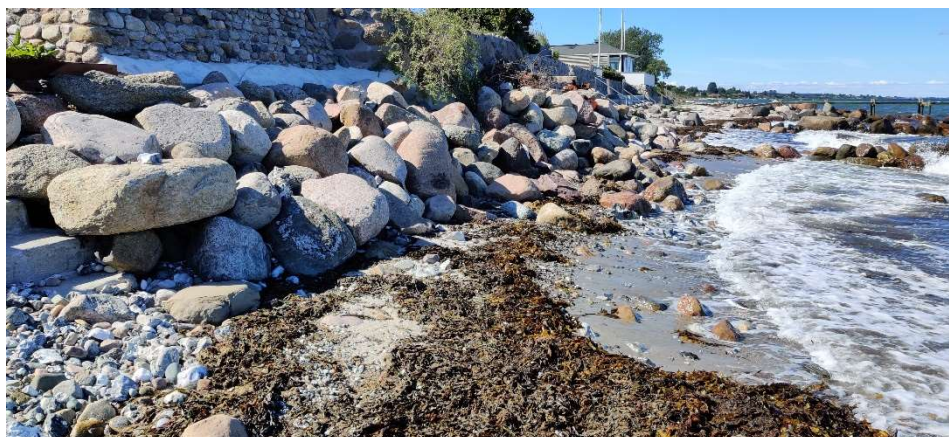
Figur 4.46: Foto af skråningsbeskyttelse på strækningen mellem St. 1090-1112. Stranden er her smal. Dette kan både skyldes, at beskyttelsen er bygget ud på stranden, og en øget erosion af stranden forårsaget af skråningsbeskyttelsen.
