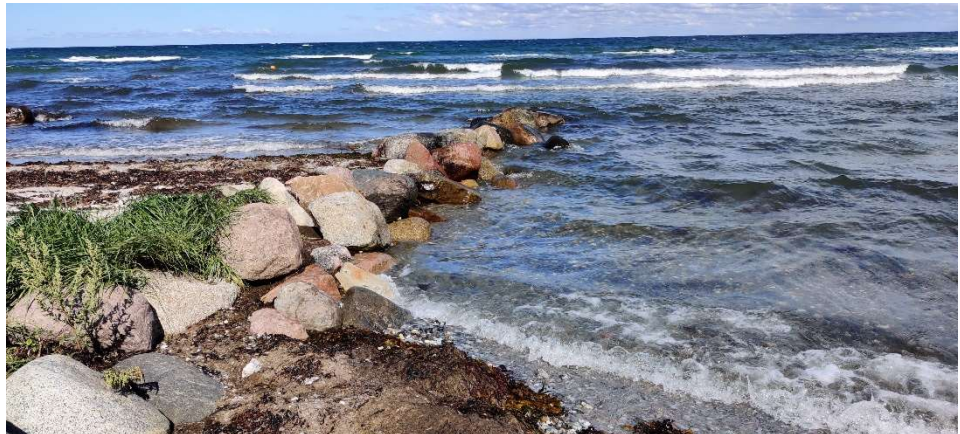
Figur 3.4: Foto af en hofde opbygget af sten med luvsideaflejring (til venstre) og læsideerosion (til højre). Fotoet er taget under kystinspektionen d. 1/9-2020.
