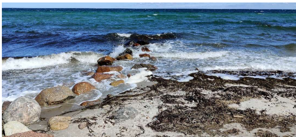
Figur 4.52: Foto af høfde, der er faldet sammen.
