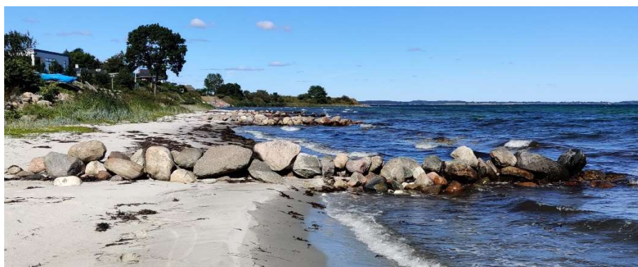
Figur 4.58: Foto af høfderne på Strækning 3. Høfden varierer lidt i højde, og foran høfden ligger mindre sten. Dette kan skyldes, at høfden er faldet lidt sammen.
